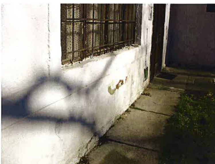
Bejárati falon felázott és burkolatlan lábazat, könyöklő nélküli ablak.
