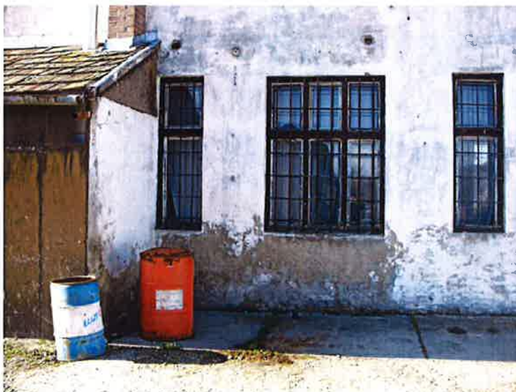
Nagyterem oldalhomlokzata felázott lábazati és mellvédfallal, burkolatlan lábazattal, málló homlokzatvakolattal a szabálytalan helyen lévő ablakokkal és bővítménnyel.
